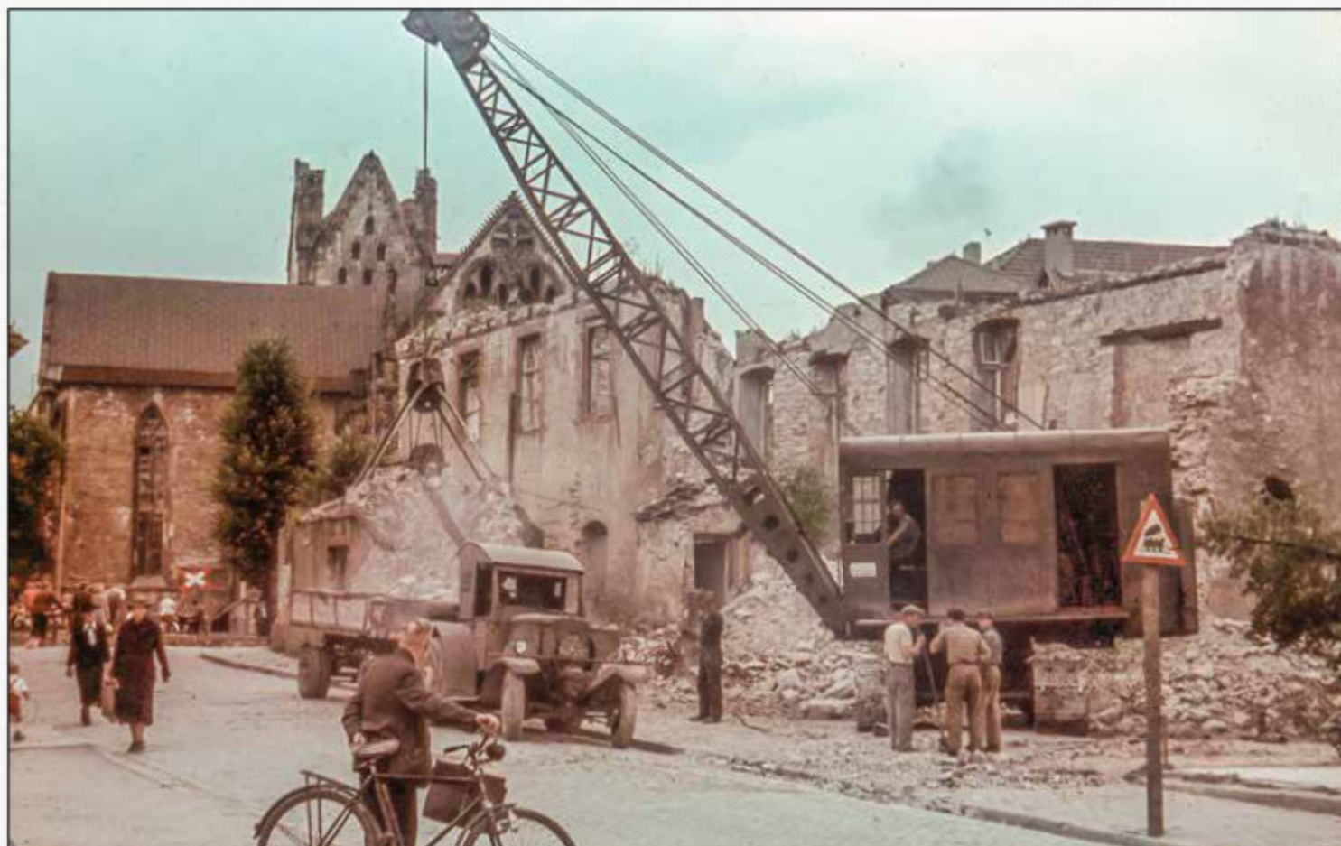
Um 1948/49 räumen diese Männer Trümmer »Am Bogen«. Abgeben von Schaufeln, Hämmern und Spitzhacken sind Maschinen wie dieser Kettenbagger, Traktor und Anhänger beim Aufräumen unverzichtbar. Das Warnkreuz im Hintergrund gibt der Trümmerbalm Vorrang vor Straßenfahrzeugen. Während der Turm der Maria, Kilian und Liborius geweihten Kathedrale noch ohne Dach auskommt, konzentrieren sich die Menschen auf Grundbedürfnisse: Nahrungsmittel, Kleidung und Hausbrandversorgung. Foto: Stadtarchiv Paderborn, Negativ-Nr. M5/01GD, Nr. 189 / Tudyka.
